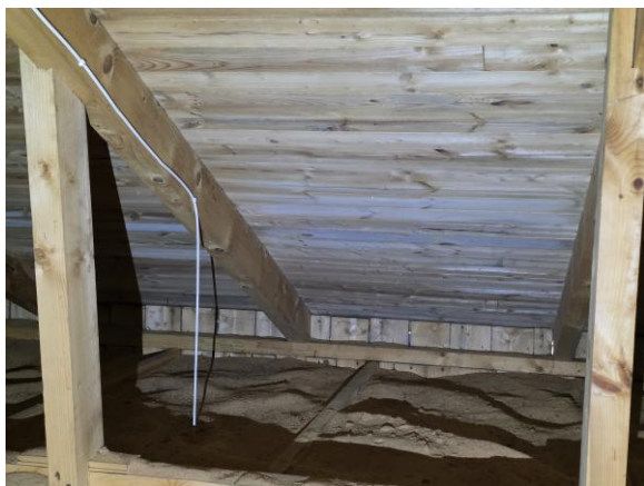
Mikrobiell påväxt på delar av underlagstaket.
